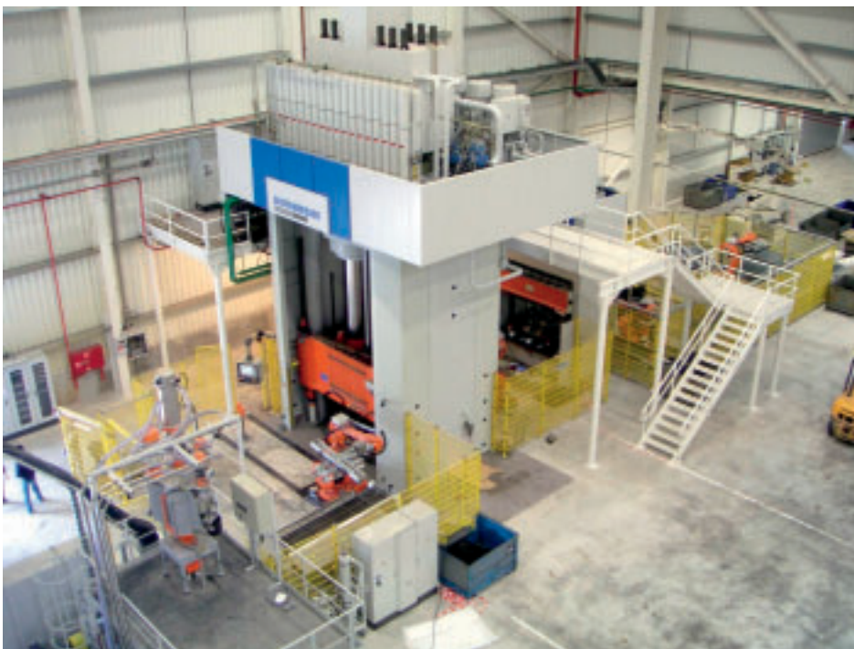
Die Aufgabenstellung: Die LFT-D Pressanlage zur Herstellung von faserverstärkten Kunststoff-Pressteilen sollte abgesichert werden (Bild: Dieffenbacher)
